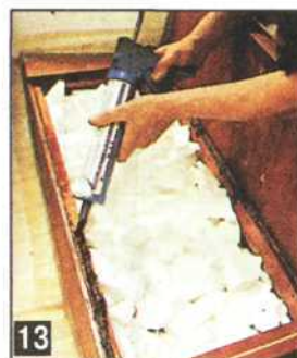
Заполняют обрезками пенопласта пространство под банками на носу и корме лодки, придавая ей дополнительную плавучесть. Сиденье кормы — съемное, что позволяет проверять рулевую систему. Опорную поверхность уплотняют герметиком.
