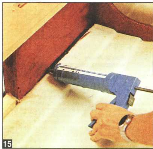
15 Усиливают сосновой рейкой киль. Уплотняют колодец для шверта силиконовым каучуком, «ламинируют» его к корпусу как минимум тремя матами.
